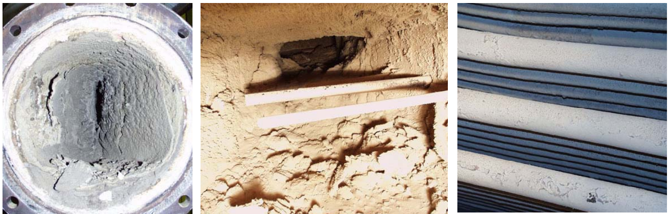
Abb. 6-20: Ablagerungen in Anlagenteilen (links: Düse vor Nachbrennkammer, Mitte: Abgaskanal hinter Nachbrennkammer, rechts: Rohre im Wärmeübertrager)
