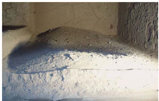
Abb. 6-15: Kesselasche im Wärmeübertrager
