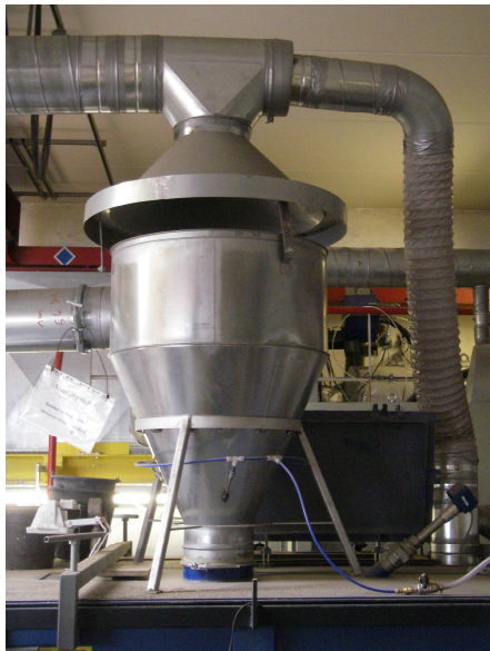
Abb. 4.2-2: Zyklon mit installierter Absaugung, Druckluft zum Freipusten (blau) und höher gesetztem Deckel
