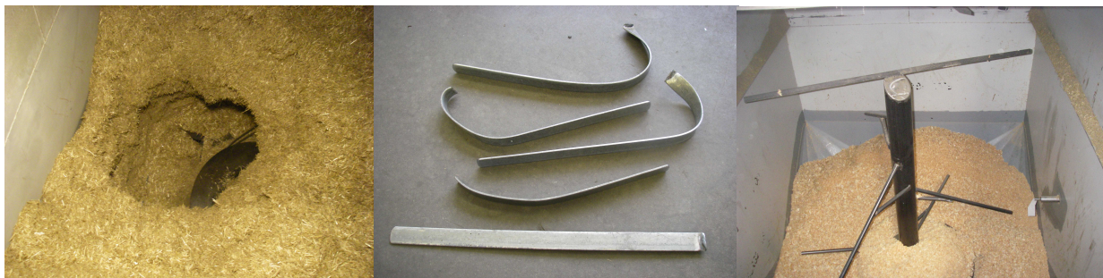
Abb. 4.3-1: Brückenbildung im Biomassebunker; verbogene Mitnehmer, neuer Mitnehmer
