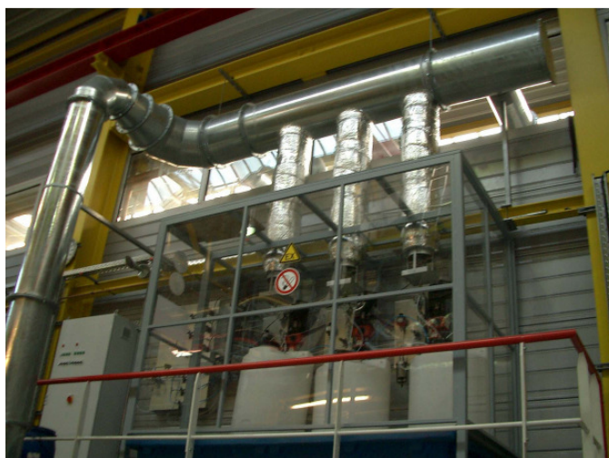
Abb. 29: Außenansicht der Dosierstation.
