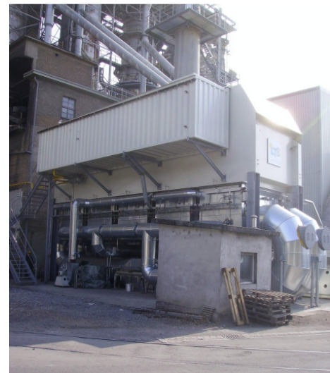
Abb. 165: RNV-Anlage zur Reinigung des Abgases aus einem Kalkbrennprozess.
