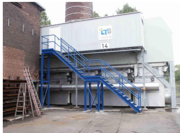
Abb. 155: RNV-Anlage zur Reinigung des Abgases aus einem Zinkrecyclingprozess.
