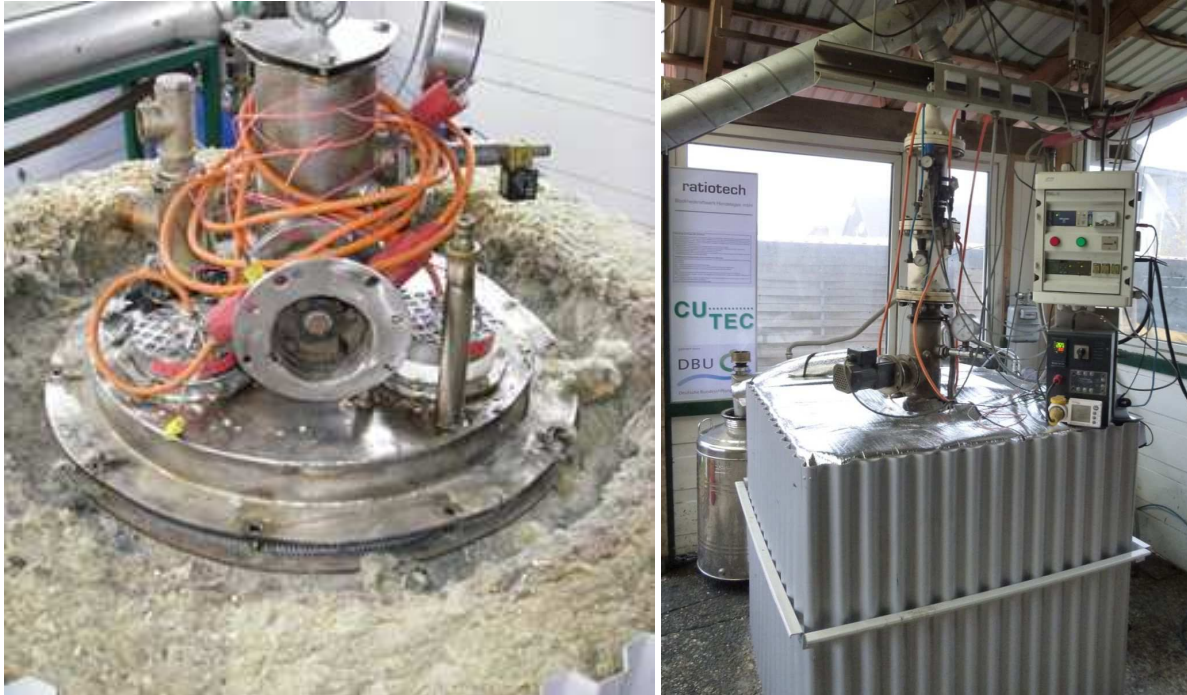
Abb. 3.3-1: Behälterdeckel unisoliert (alt, li.) und isoliert mit aufgesetzter Glocke (neu, re.)
