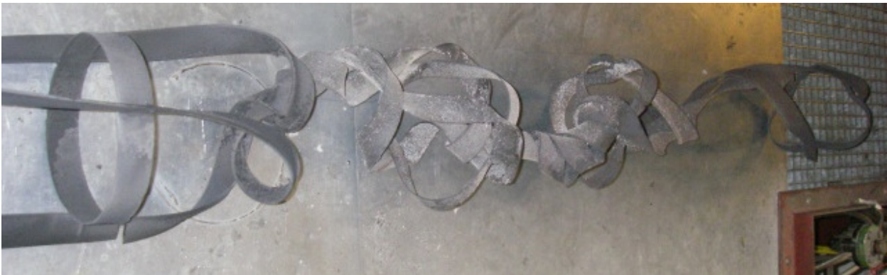
Abb. 5.4-4: Statischer Mischer nach Materialerweichung durch thermische Überlastung, ausgebaut
