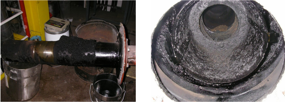
Abb. 5.4-5: Kondensierter Pyrolyseester auf der Eintragschnecke (links) und am „kalten“ Drehrohrende (rechts); hinten auf dem rechten Foto ist das Feststoffwehr zu sehen, auf dem linken Foto ist die Lage des Feststoffwehres an der blank geschliffenen Stelle der Eintragschnecke erkennbar.
