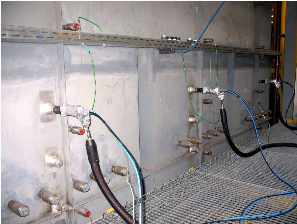
A1.18: Drei wassergekühlte Sonden mit beheizten Messgasleitungen.
