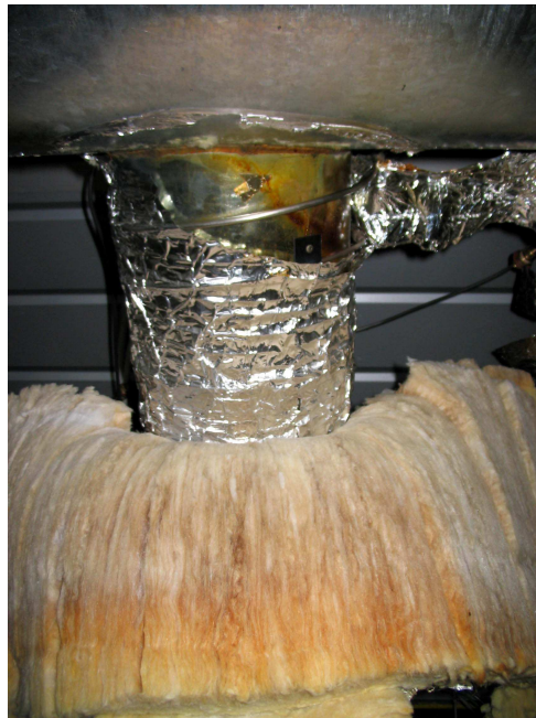
A1.33: Verbranntes Dichtungsmaterial am Übergang Ansaugstutzen 2 / Sammelleitung.
