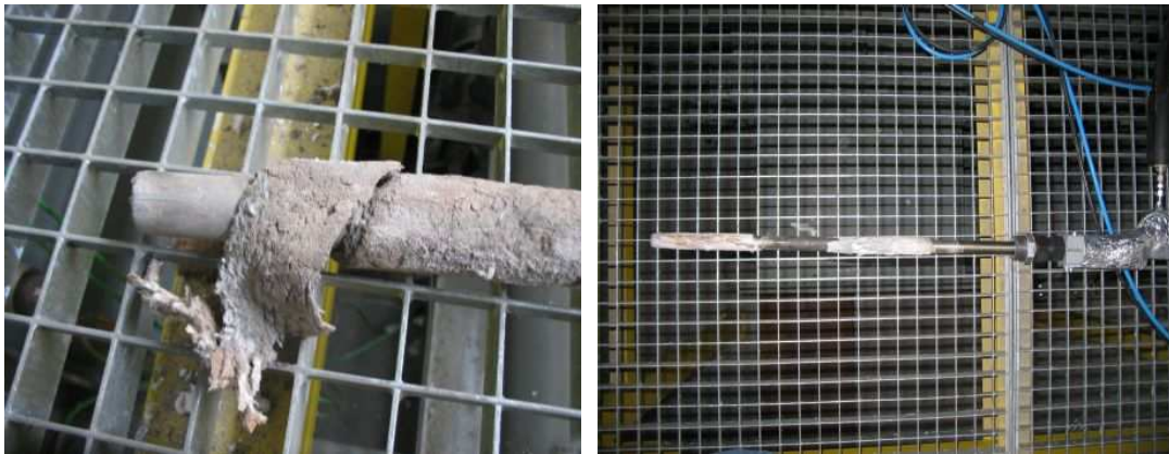
A1.24: Sonden mit beschädigter Wärmeisolierung, gewickelte Keramikfaser.
