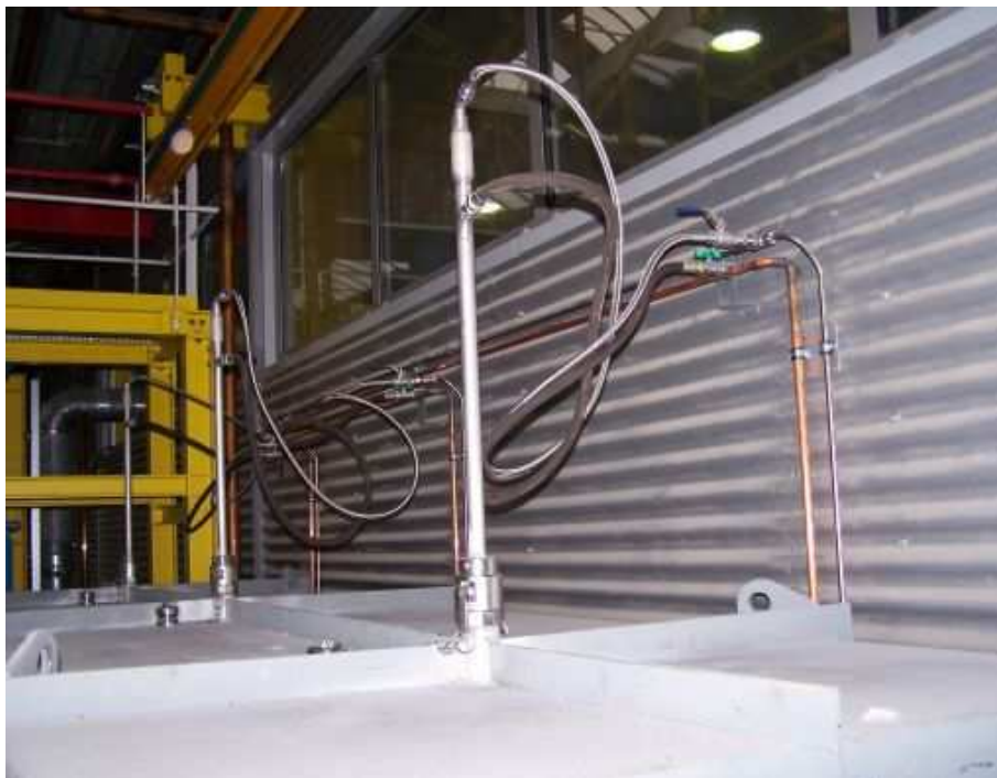
A6.3: Installation der DENOX-Lanzen oberhalb der RNV.
