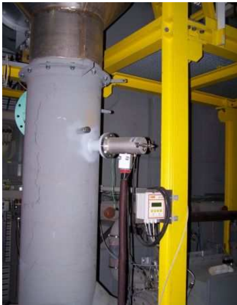
A1.27: Reingasmessstelle im Kamin.
