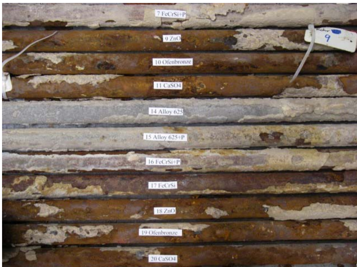
Abb. 5-17: Zustand der Rohre nach Ausbau: MVR Hamburg
