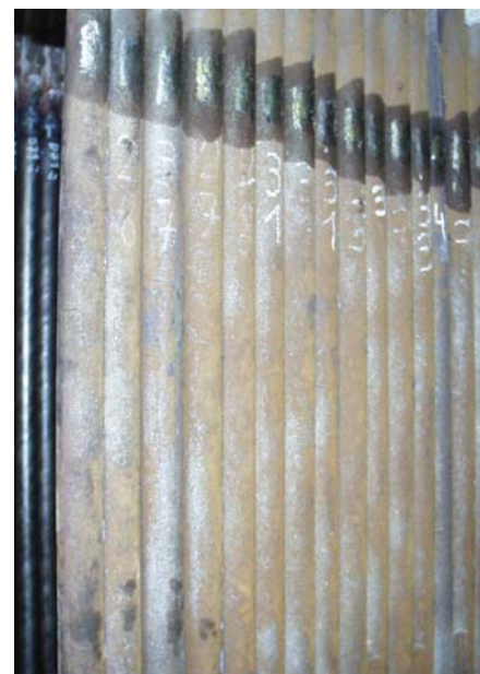
Abb. 5-6: Eingebaute Rohre in der KVA Bern (Foto mit unbeschichteten, benutzten Rohren)
