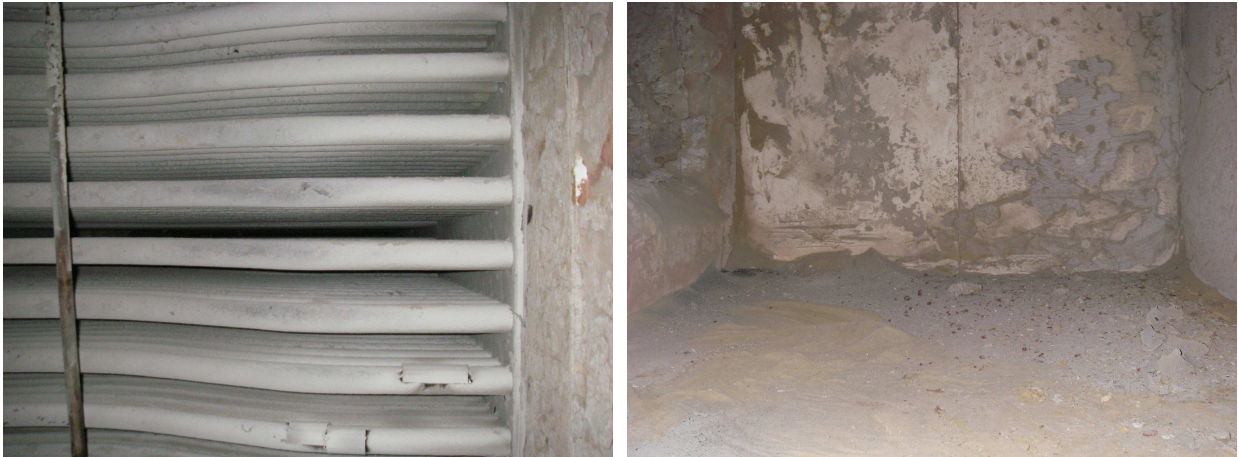
Abb. II.5.2.1-4: Ablagerungen auf den Rohren und im unteren Teil des Wärmetauschers
