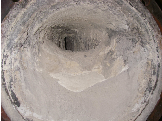
Abb. II.5.1.1-2: Ablagerungen in der Rohgasstrecke
