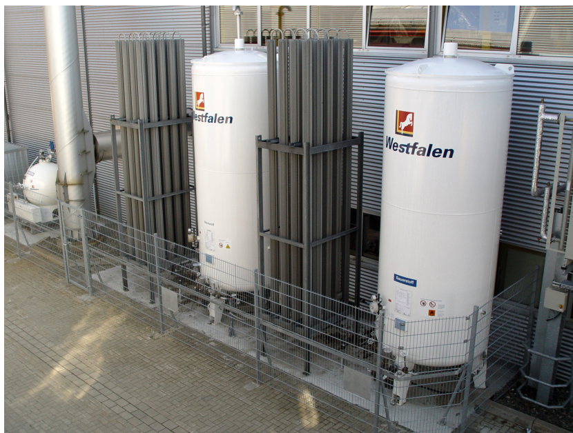
Abb. 6.1-3: Gasversorgungsstation an der Halle Nord
